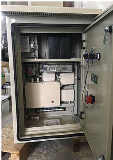
Hình 14. Hình ảnh tủ điều khiển.
